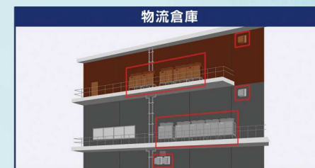
ビル用エアコン室外機 & ウェザーカバー
